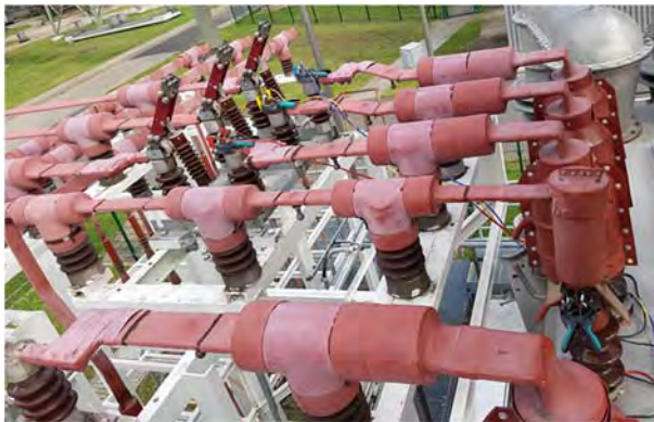
Bild 2: Wicklungswiderstandsmessung US-Seite am 40MVA, 110/10,5/10,5kV Transformator, Bj. 1974
