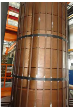
‚Buckling‘ an einer US- Wicklung eines 50MVA/220kV-Trafos
