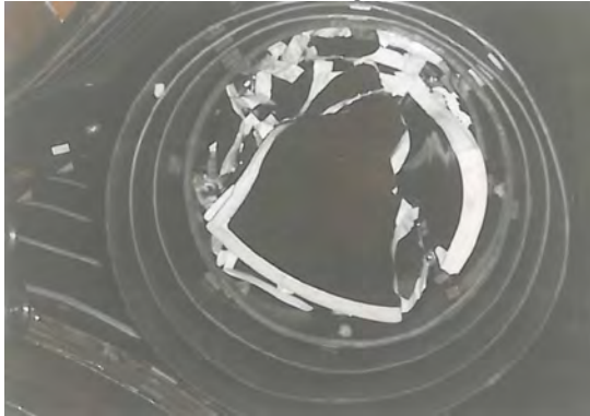
a.) 350MVA/400kV- Transformator. Eine 400kV-Durchführung wurde zerstört. Porzellanscherben liegen im Ausleitungstrichter.
